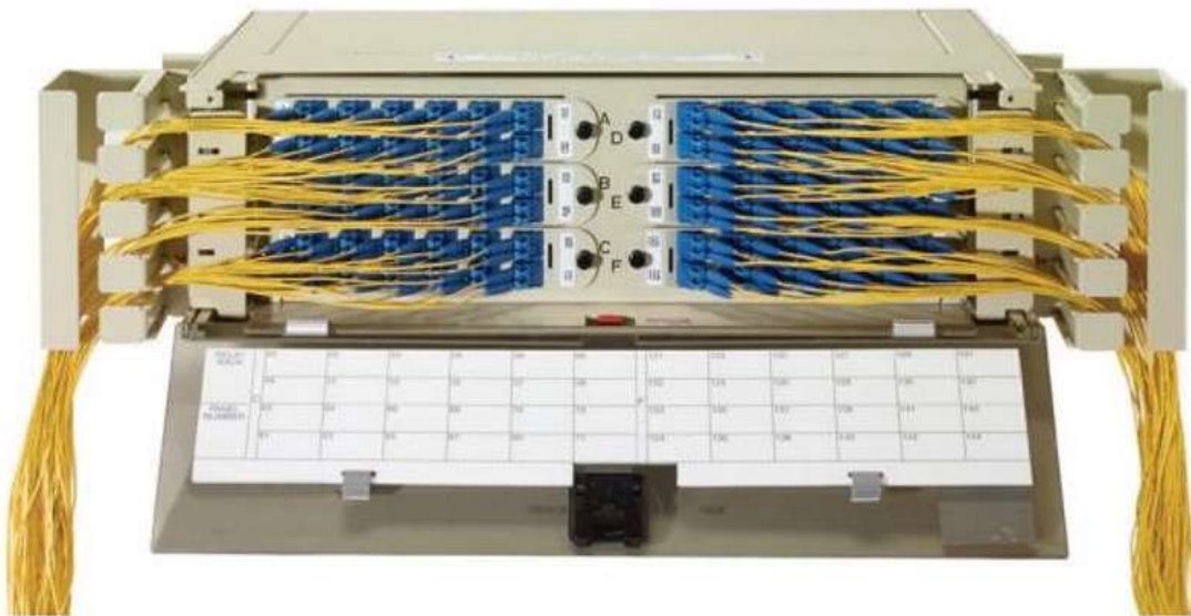
Fig. 5 Conexiones Cruzadas en Patch Panel
